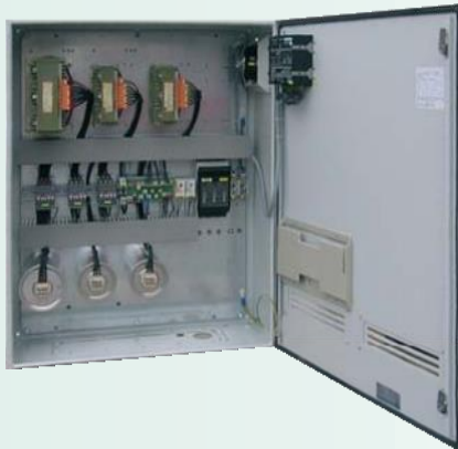
Regelanlage GDX81 50/4 CLD4 14% Verdrosselung, Schutzart IP 20
